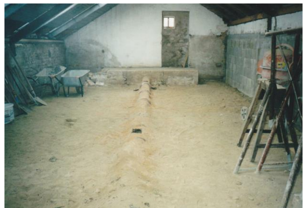
Abzugsrohr im Boden „Fuchs“
